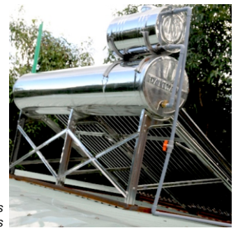
Premier chauffe-eau de 300 litres l'eau est à 65 degrés
